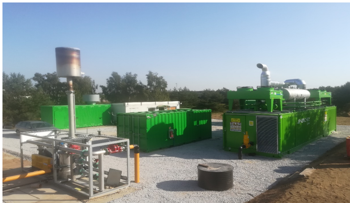
Instalacja biogazu składowiskowego 1 MW wybudowana przez Biowatt
