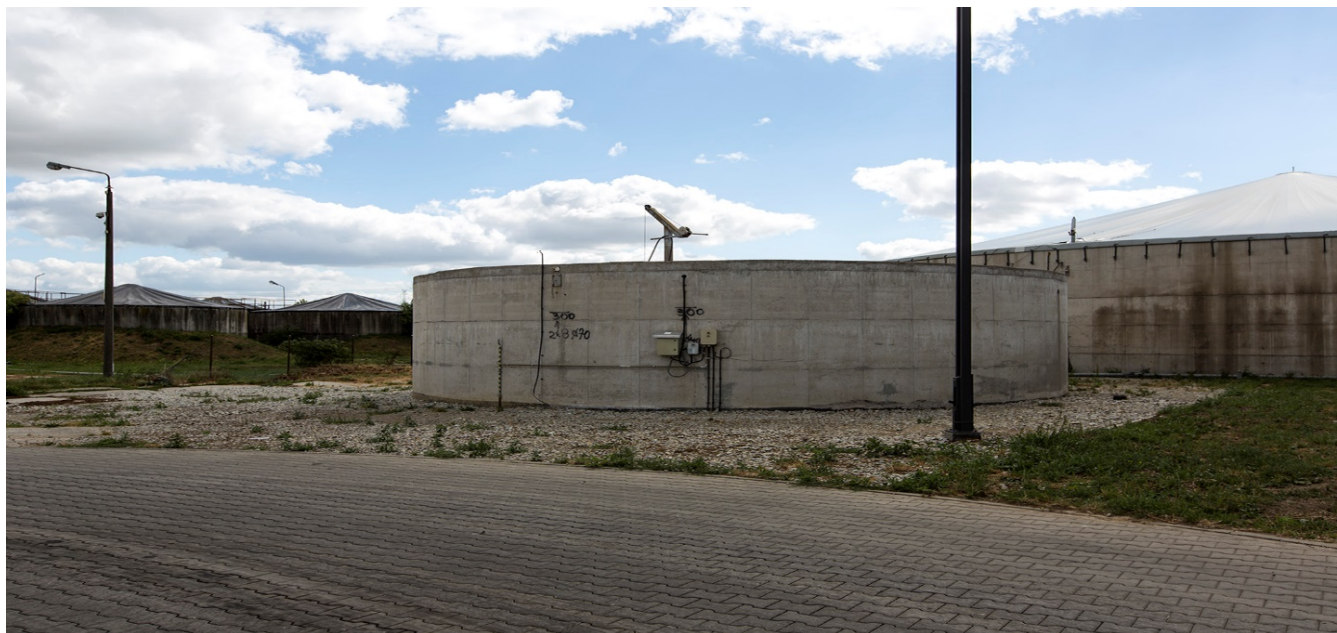
Zbiornik gnojowicy na instalacji biogazowni rolniczej Biowatt
